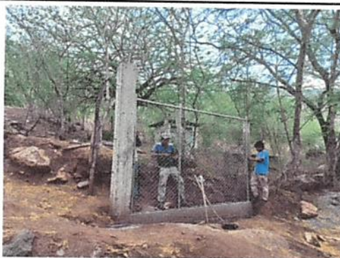
Foto 2: Circulando con malla, en area en mal estado
